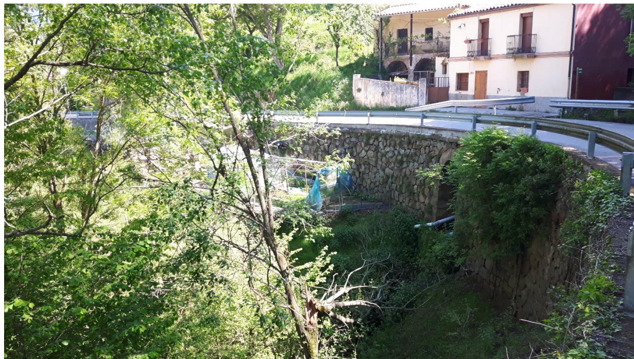
Fotografia núm. 6. Obra de fàbrica existent a l'altura del PK 0+460 de projecte.
